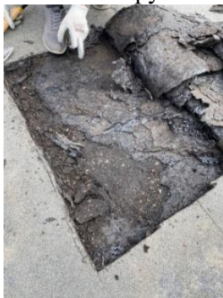
Рисунок 4 – Шар асфальтобетонну в покрівлі
