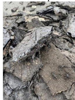
Рисунок 5 – Шар асфальтобетонну в покрівлі
