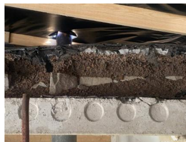
Рисунок 9 – Структура покрівлі пошкодженої будівлі
