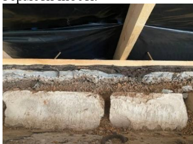
Рисунок 8 – Структура покрівлі пошкодженої будівлі
