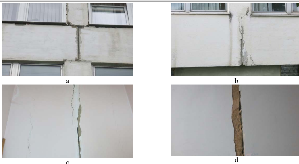
Рисунок 3 – Деградація з'єднань між зовнішніми стіновими панелями корпусу біологічного факультету УжНУ станом на 29.06.2023 р.: а – деградація стиків зовнішніх стінових панелей і сліди карбонізації бетону; б – те ж деградація бетону в стикі і карбонізація опорних частин панелей, тріщини і сліди корозії арматурних сіток; с – те ж деградація бетону стика, тріщина в верхній частині панелі; d – деградація бетону стика у деформаційному шві в осях “13 – 14” на першому поверсі.
