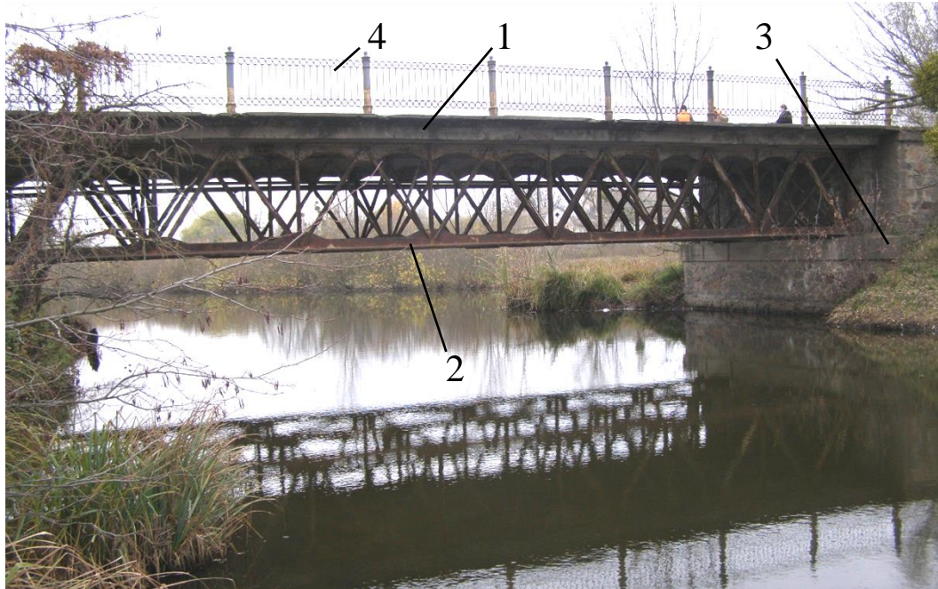
Рисунок 1 – Загальний вигляд стале залізобетонного мосту на автодорозі державного значення Р-33 у смт. Дашів до реконструкції. Тут: 1 – залізобетонна двохконсольна прогонова плита, 2 – просторова сталева ферма, 3 – берегова опора, 4 – перильне огородження.
