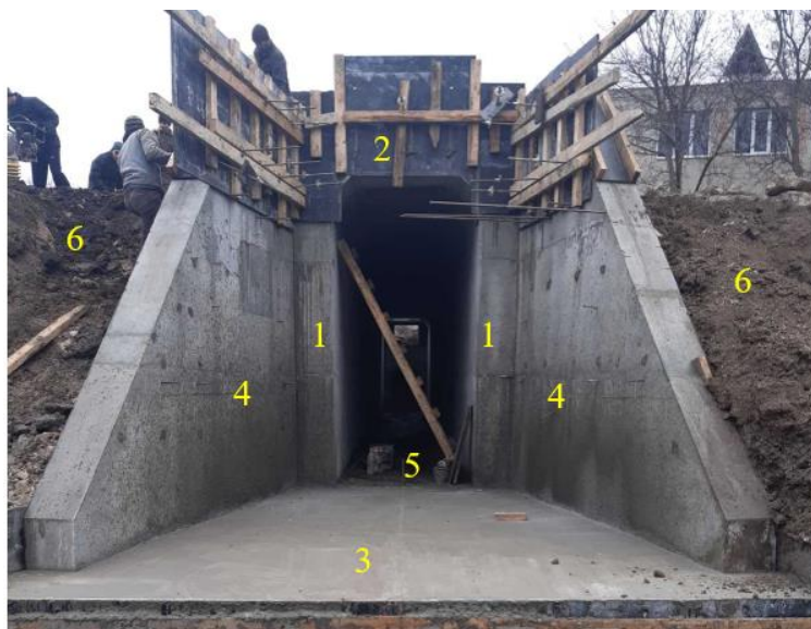
Рисунок 3 – Загальний вигляд комбінованої споруди тунельного типу з боку водоскидного отвору на автодорозі місцевого значення С-02-09-04 у с. Джугастра Крижопільського району Вінницької області. Тут: 1 – опорні стінки тунелю, 2 – верхня плита тунелю, 3 – водоскидна плита, 4 – відкрilки, 5 – плита днища тунелю, 6 – земляний насип.
