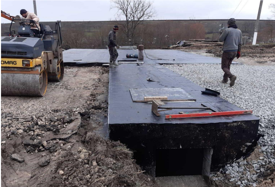
Рисунок 16 – Завершальний етап будівництва тунелю в момент улаштування горизонтальної гідроізоляції та підготовки основ дорожнього одягу (вид з боку, протилежного водоскидному отвору).
