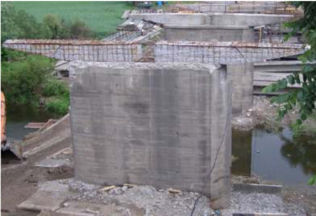
Рисунок 3 – Стан армування ригелів мостових опор після оббивання слабого бетону. Масова шарувата корозія верхньої (робочої) арматури внаслідок дефектів захисного шару та тривалого замочування.
