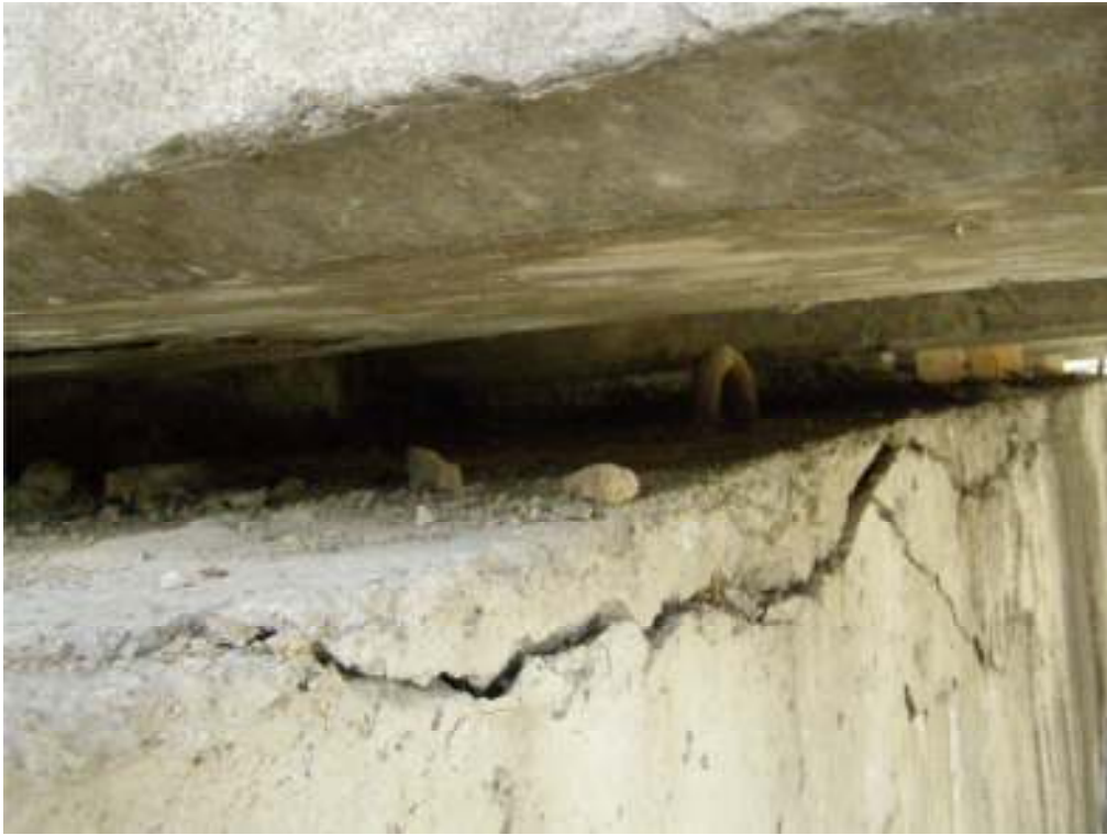
Рисунок 2 – Характерне руйнування (відшарування) захисного шару верхньої (робочої) частини ригеля на консольних звисах мостової опори внаслідок тривалого замочування та збільшення динамічного навантаження на мостову опору через.
