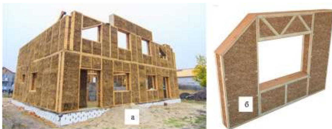
Рис. 11. Приклади зведення стін будинків за допомогою готових панелей з пресованої соломи (а) та приклад готової стінової панелі (б)
