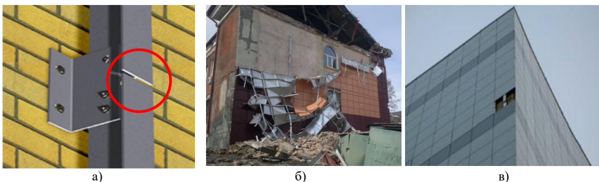
Рисунок 7 – Монтаж з компенсаційним проміжком вертикальних напрямних профілів (а), руйнування каркасу (б) та випадіння матеріалу облицювання (в)
